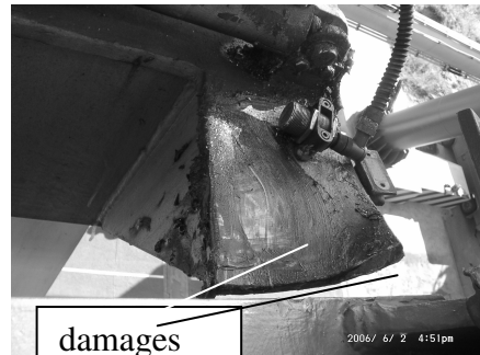
Fig. 3. Damages of the lock and cylinder support Rys. 3. Uszkodzenia podpór rygla i siłownika
